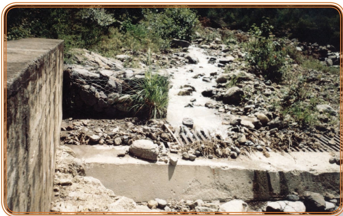
Fotografía N° 3 Taponamiento de rejilla por acarreo de sedimentos en toma Apote
