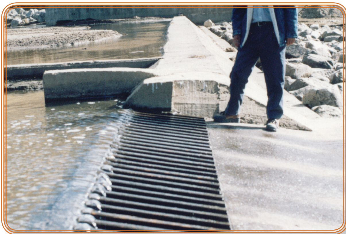
Fotografía N° 6 Vista del azud con el emplazamiento de la Toma Tirolesa en Titiri
