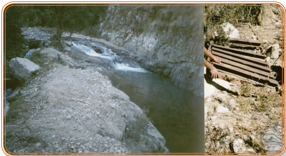
Fotografía N° 5 Obra de Toma Tirolesa de Laimiña con rejilla extraída de la estructura
