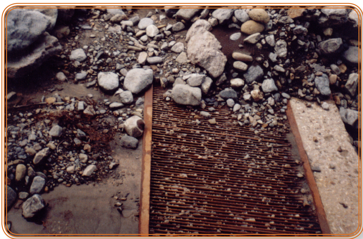
Fotografía N° 2 Toma Kora Tiquipaya, se aprecian sedimentos acumulados en la rejilla
