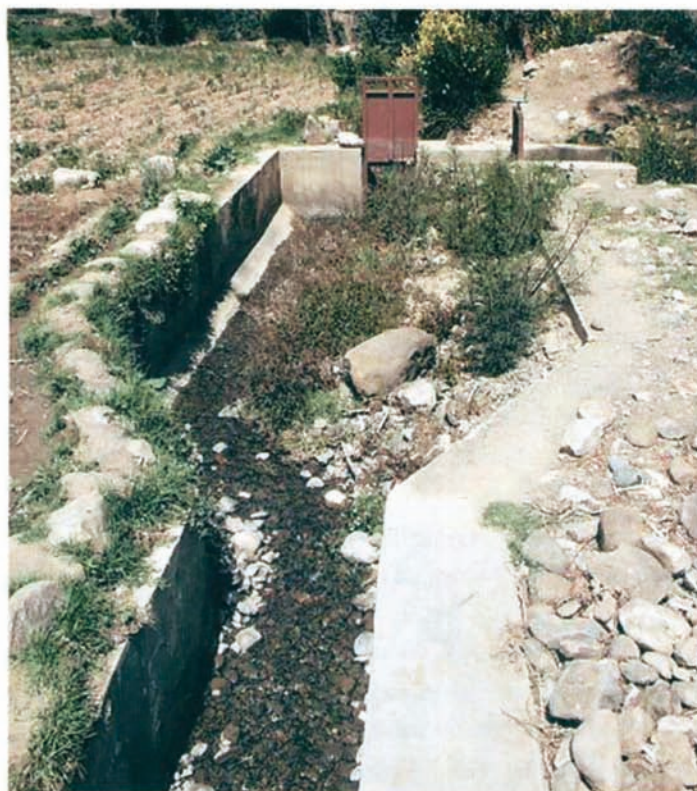
Figura 15.6: Desarenador inoperable por falta de limpieza
