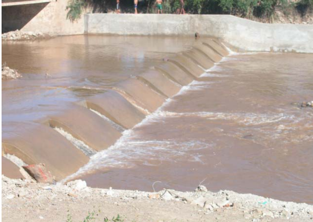
Azud derivador con aberturas para regular las crecidas en el río San Isidro, Santa Cruz.
