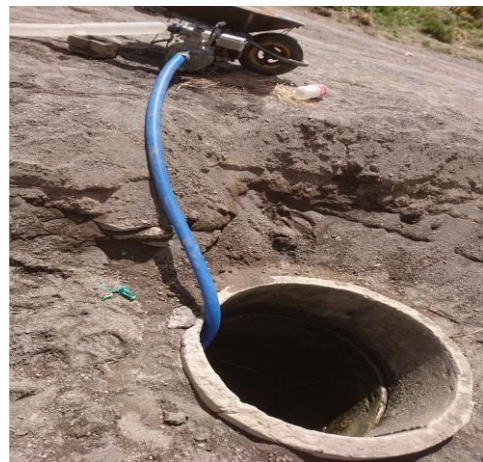
Toma de agua subterránea comunidad Umitiri
